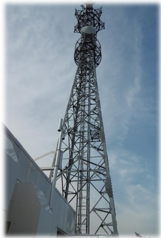
消防救急デジタル無線
