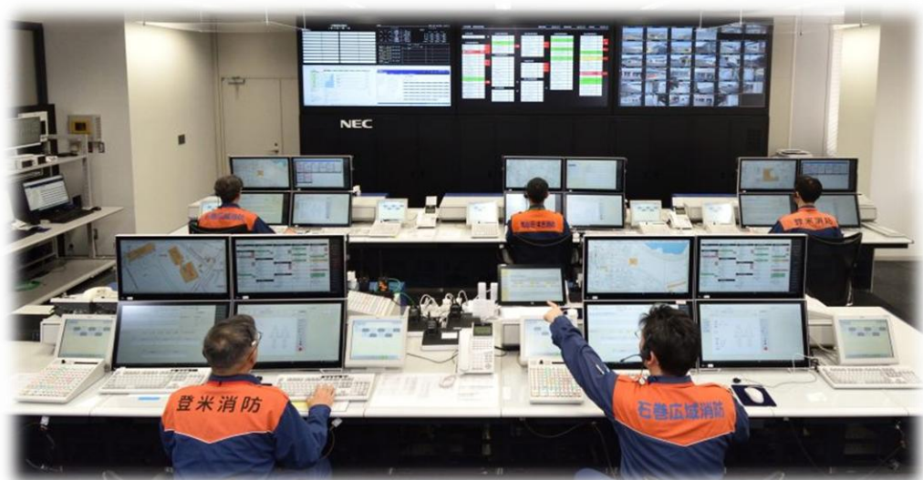
宮城県東部消防指令センター 指令台
