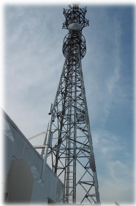
消防救急デジタル無線
