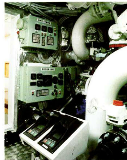
機関室操作盤
