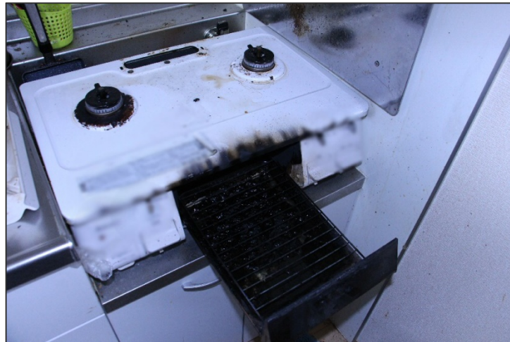
▲ガスこんろの状況。グリル内には蓄積した油脂類が認められる。
