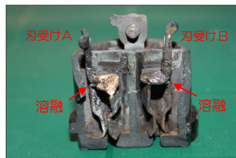
▲刃受けを復元した状況。向かい合った異極端子が溶融しており、当部分でトラッキングが発生したものと推定することができる。
