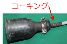
▲Aの防水型コネクターのコード孔のコーキング材に劣化が認められる。
