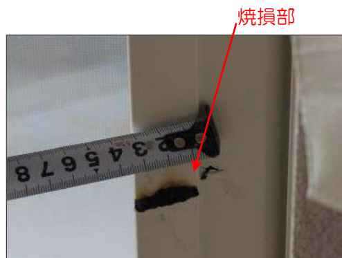
▲樹脂サッシ焼損状況（現場）
