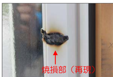
▲再現実験焼損状況
