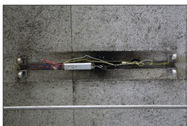
▲焼損した蛍光灯付近の焼損状況（カバー等撤去後）
