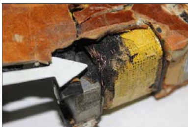
▲コイルの一部が断線、溶融しており、層間短絡が認められる。
