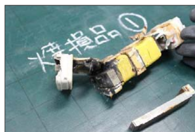
▲端子金具とコイルの接続部分。樹脂硬化剤は炭化・焼け崩れ、接続部分の半田は認められず、被覆は焼失、巻き線は露出している。
