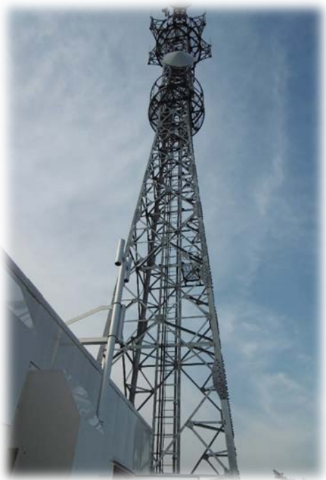
消防救急デジタル無線
