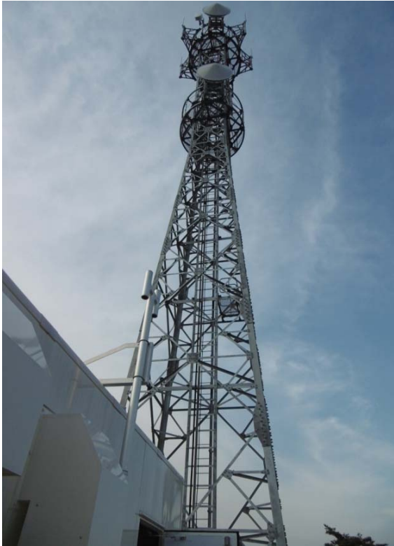
消防救急デジタル無線
