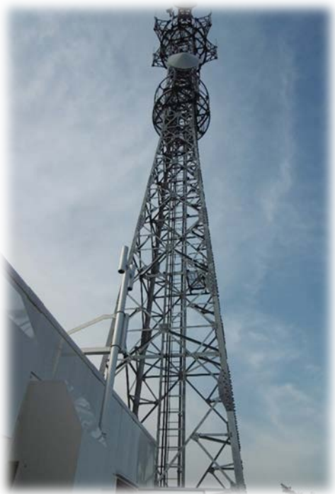
消防救急デジタル無線
